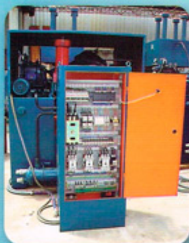
Controles Allen Bradley, Siemens u otro similar de acuerdo a sus necesidades.
